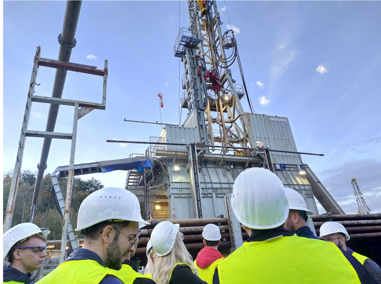
Besuch der Geothermieranlage „Enerpipe“ im Rahmen des SupportDHC Kick-off-Meetings
